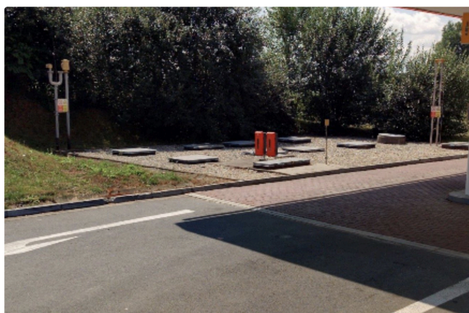
Stáčiště a podzemní nádrže
